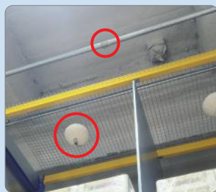
■ 각 격리공간 소화설비 설치
