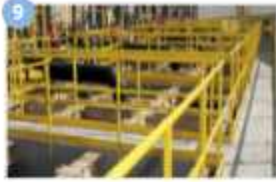
9 추락방지시설 (안전난간, 방벽, 개구부덮개, 미동식 사다리 등)
